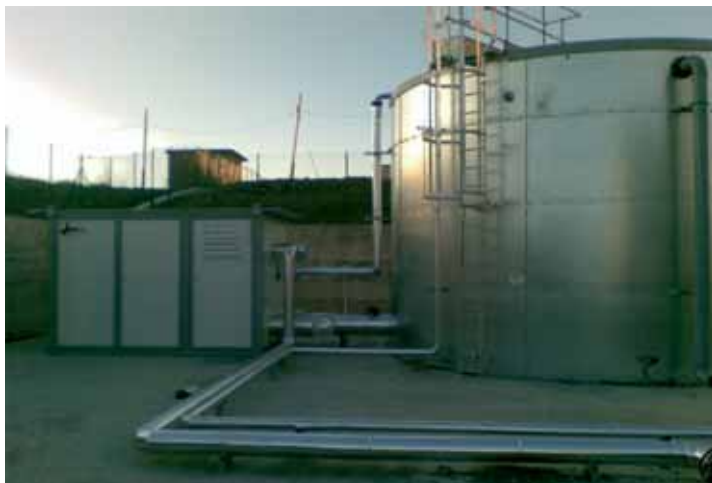
FIREBOX® con pompe orizzontali sottobattente Alimentazione sprinkler e rete idranti - Fonderia - Siena (SI)
