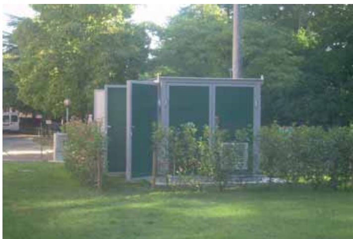
FIREBOX® con pompe verticali sottobattente Alimentazione rete idranti - Casa di riposo - Brisighella (FC)
