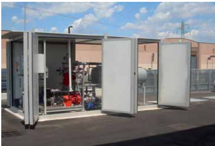
FIREBOX® con pompe orizzontali soprabattente Alimentazione rete idranti - Industria cartaria - Cento (FE)
