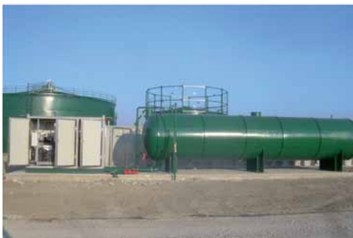
FIREBOX® con pompe orizzontali sottobattente Alimentazione rete idranti - Centrale Biogas - Ferrara (FE)
