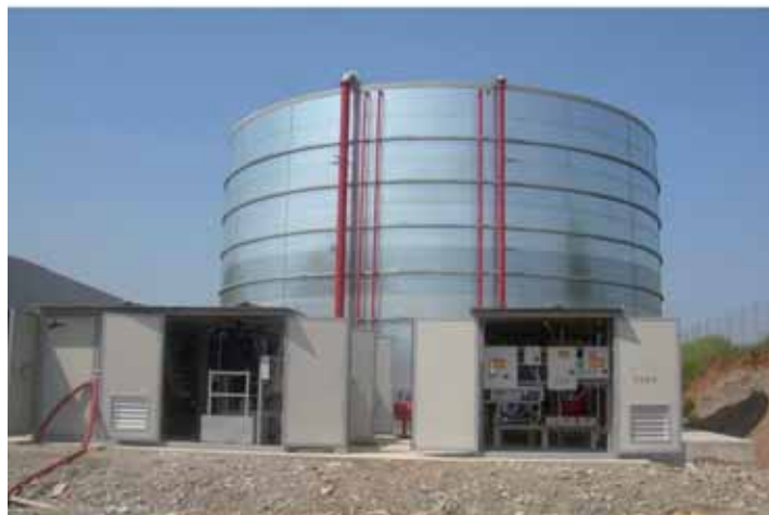
FIREBOX® con pompe orizzontali sottobattente Alimentazione sprinkler e rete idranti - Centro logistico - Chiari (BS)
