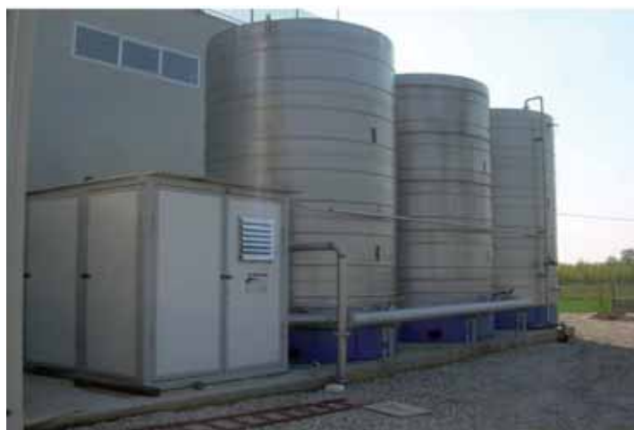
FIREBOX® con pompe orizzontali sottobattente Alimentazione rete idranti - Industria alimentare - Lavezzola (RA)
